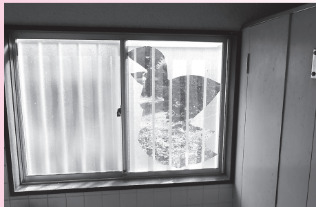
成知公園トイレ (被害日 6月22日～23日頃)
