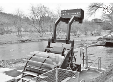
平根マイクロ水力発電所
