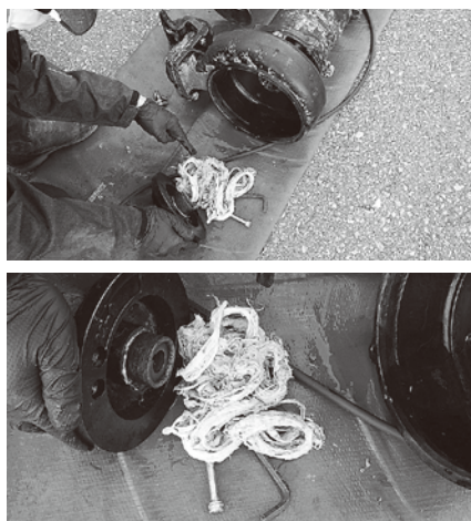
ポンプに絡まる繊維物
