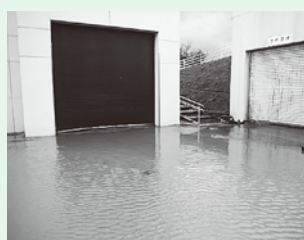
被災直後の水処理棟付近
