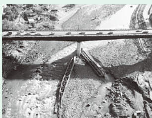
流失した水管橋
