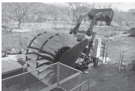
平根マイクロ水力発電所
