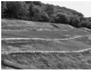
一部崩れかけた法面
