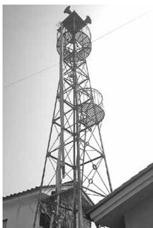
老朽化が進む警鐘楼（火の見櫓）
