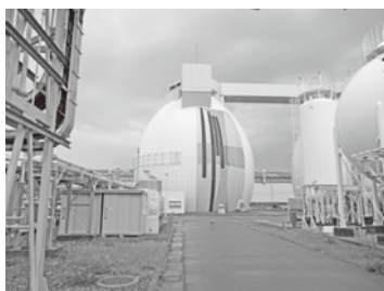
汚泥をガスと水に分解する消化タンク（こうべバイオガス）
