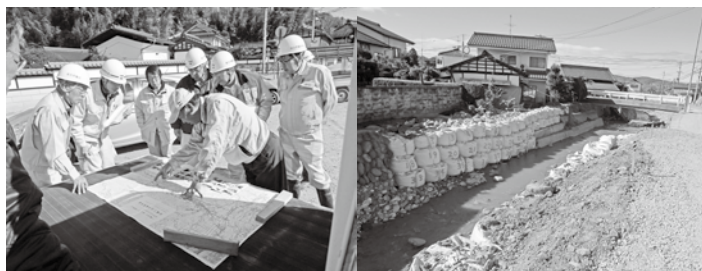
谷川の被災状況を確認（入澤区）
